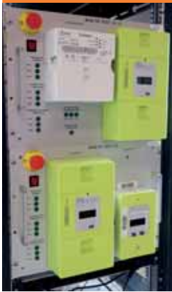
Une baie de test de Linky au Linky Lab de Nanterre. On y voit un concentrateur, un Linky monophasé et deux Linky triphasés.
